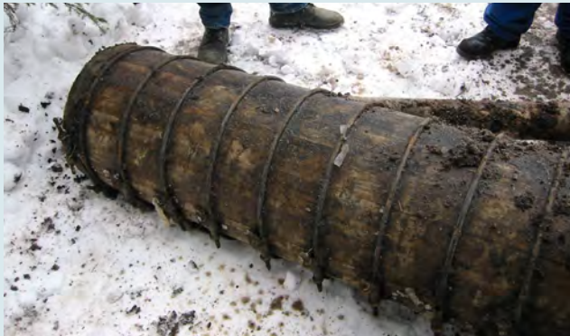
Trerør var vanlig tidligere. Dette er fra Sætervann og ble skiftet ut i 2003.
