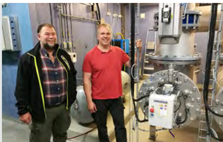
Dag-Runar Hansen og Ketil Borgevad ved UV-anlegget på Røysjø vannbehandlingsanlegg i 2017.
