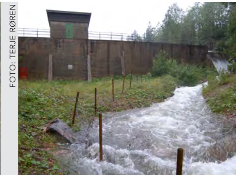
Mye vann i flomløpet fra Sætervann.
